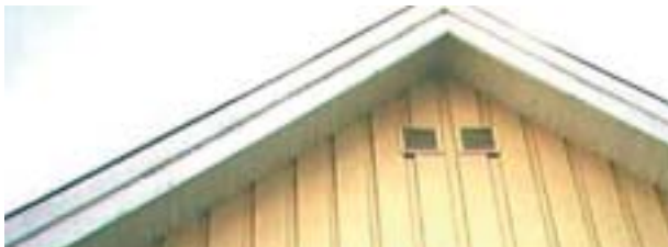
Bild 4. Ett par gavelventiler räcker
